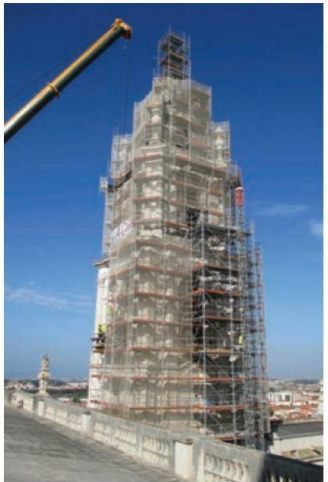
Figs. 4 e 5 Autogrua, apeamento sinos torre norte, andaimes e elevador monta cargas © AOF
